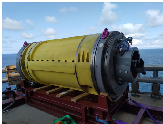
Einer der drei RB-Kompressoreinschübe, die Everllence auf Equinors Troll-A-Plattform in der norwegischen Nordsee installiert und in Betrieb genommen hat. © Everllence
