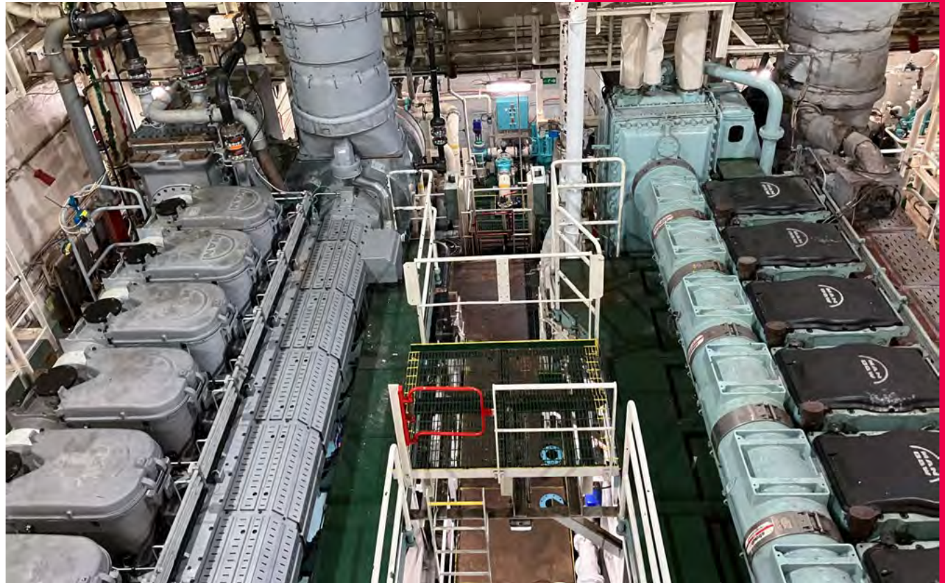
Motor nach Umrüstung auf die zukunftsfähige 51/60R-Plattform
